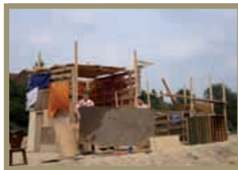
Veel sites liggen jaren braak. Verenigingen kunnen ze zonder problemen tijdelijk gebruiken, zoals hier met de bouwspelplaats van Yota op Thurn & Taxis
